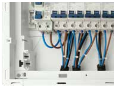
Amplio espacio para cableado
